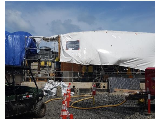
Generador y turbina gas
