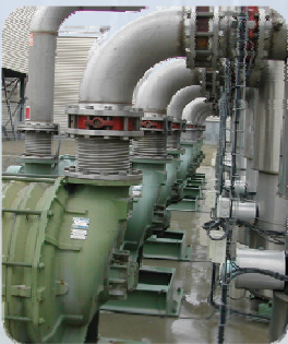
Soplantes de biogás
