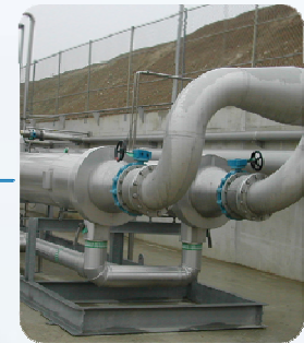
Tratamientos del biogás
