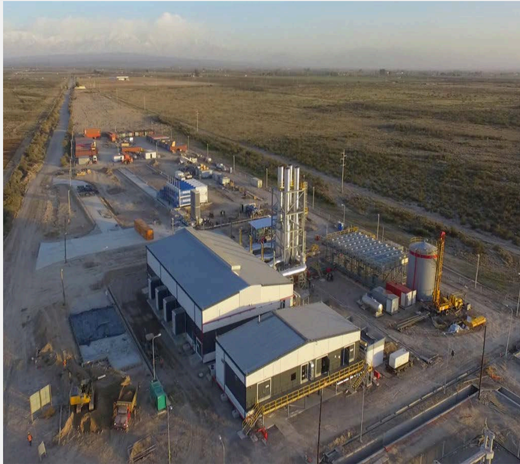
Central térmica Anchoris
