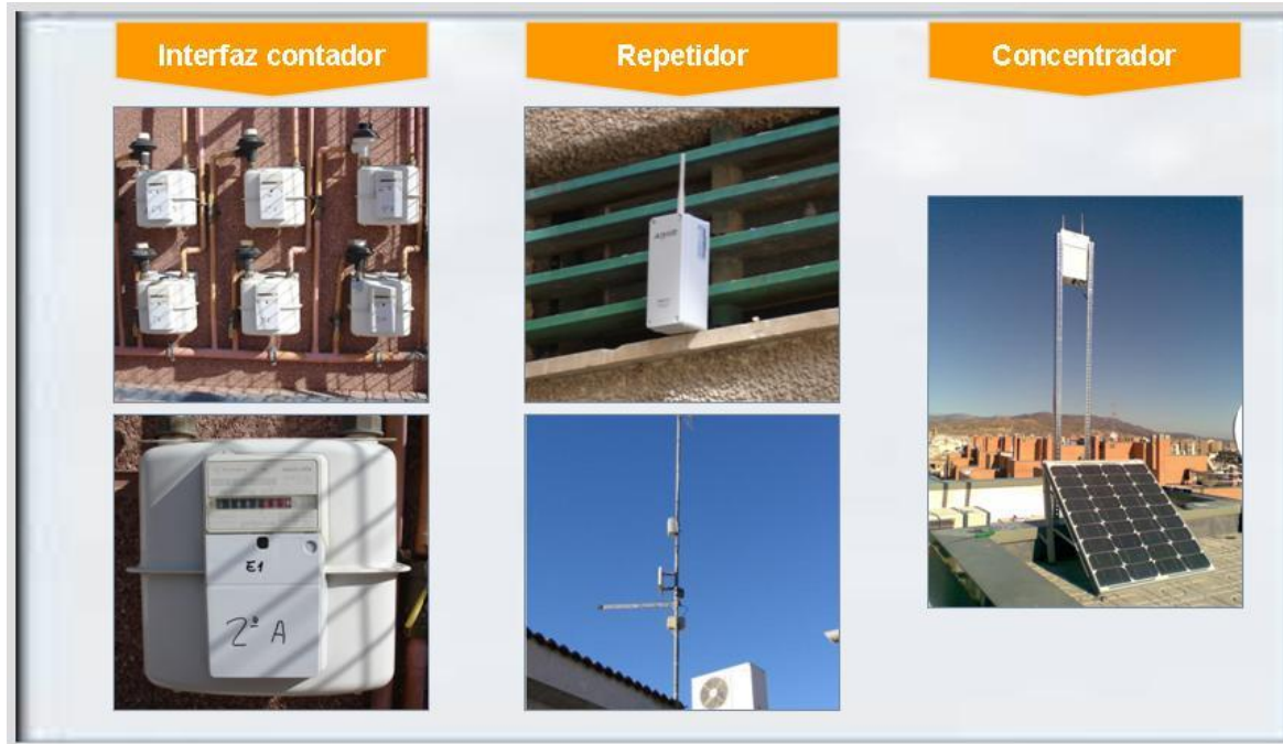
Contadores inteligentes de gas instalados en Murcia por Gas Natural
