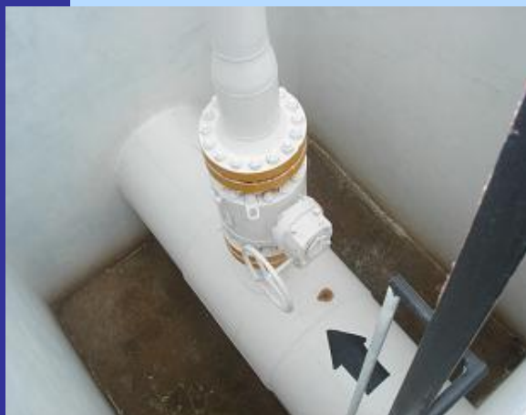
Punto de interconexión
