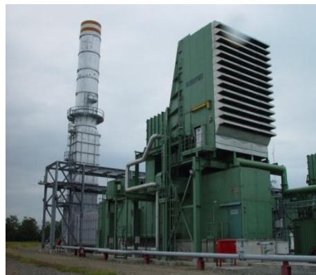
Central Térmica Machala Power
