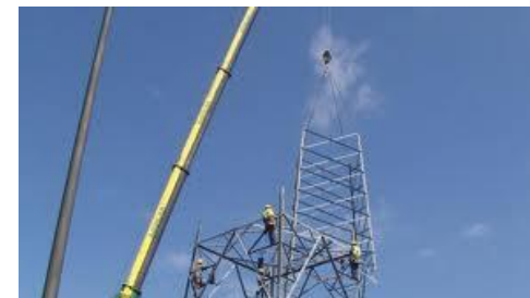
Torre de Alta Tensión
