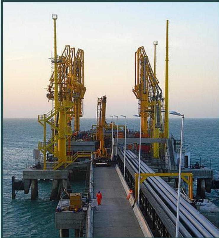
Terminal Brazos de cargamento y de descarga
